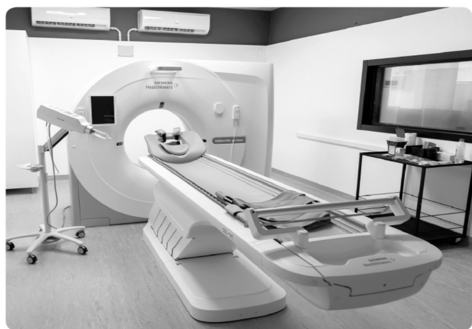
Nuevo tomógrafo en el Hospital San Antonio de Gualeguay, Entre Ríos.
